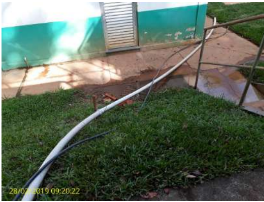
Foto 19 - Duto para passagem da água do retorno da descarga dos filtros. Deve ser fixado de forma definitiva.
