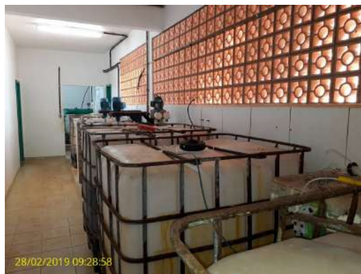
Foto 28 - Tanques de solução
