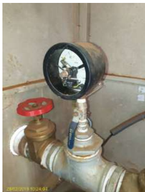
Foto 47 - Manômetro instalado no cavalete
