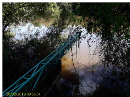
Foto 10 - Suporte para o mangote que abriga a bomba submersa também.
