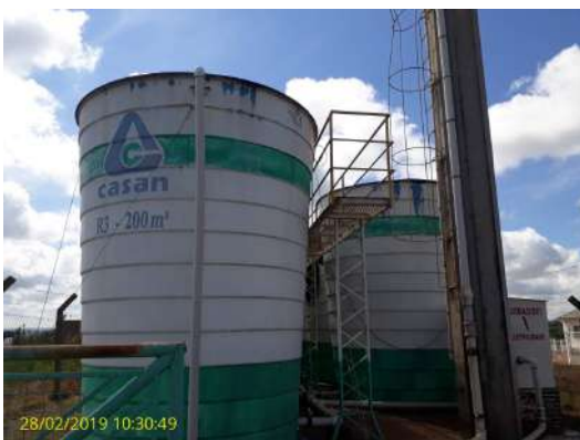
Foto 70 - Conjunto de reservatórios em fibra
