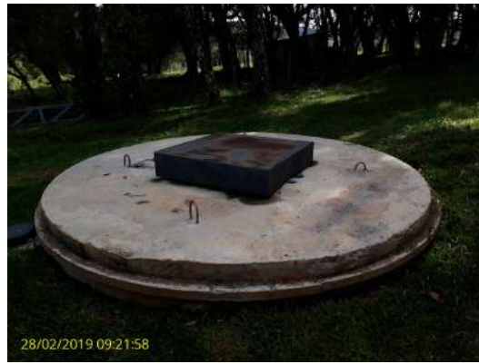
Foto 20 - Tanque para recalque do lodo para os bag. A bomba de recalque possui potência limitada segundo o operador, sendo assim não está passando todo o lodo para os bags, o excesso está indo para o rio.
