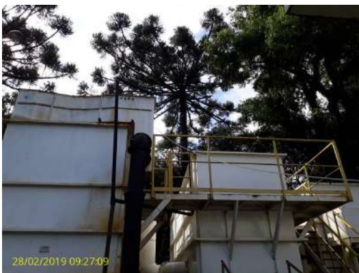
Foto 23 - Mangueira de PAC está instalada de forma improvisada. Sugere-se fixar sobre elemento rígido.
