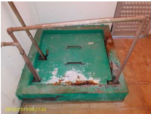
Foto 30 - Há necessidade de substituir a tampa por outra de material anti-corrosivo
