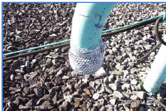
Imagem 30: Tela de proteção de um dos dutos de ventilação do Reservatório R 02A.
