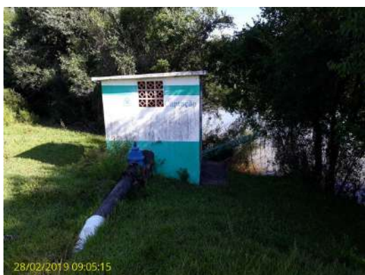
Foto 9 - Adutora de água bruta
