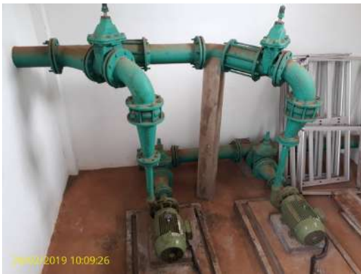
Foto 41 - Cavalete e conjunto moto bomba
