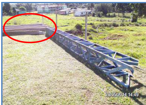
Imagem 8: Tubulações expostas às intempéries climáticas.
