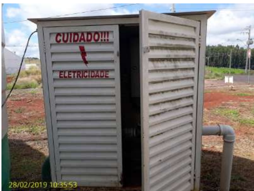
Foto 50 - Armário que abriga a bomba
