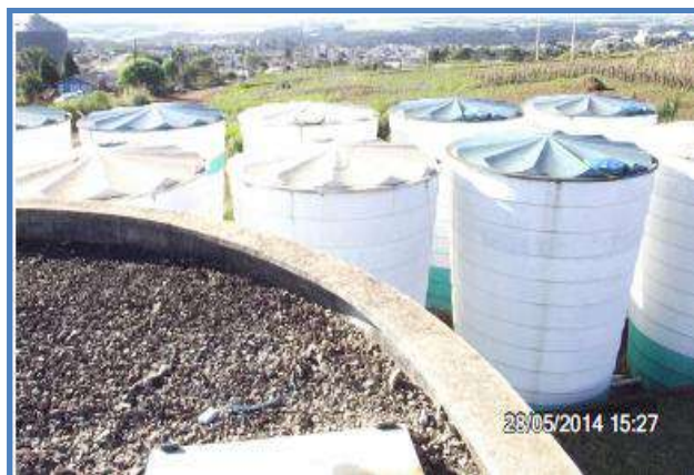
Imagem 33: Reservatórios R 02B.
