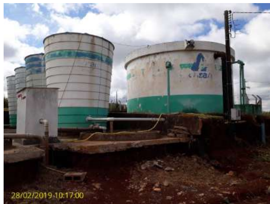
Foto 62 - Algumas caixas apresentam vazamento devido a fissuras, também falta tampa em uma das caixas de fibra
